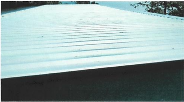
Foto 3: Estado actual de la lámina.
